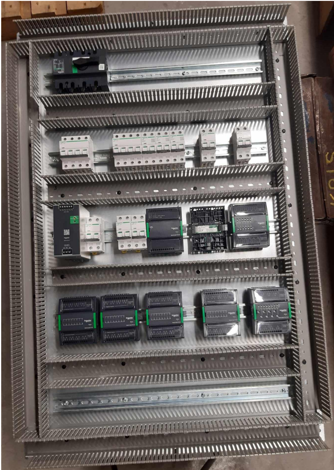
Figuur 44: HVAC-kast met BMS-componenten
