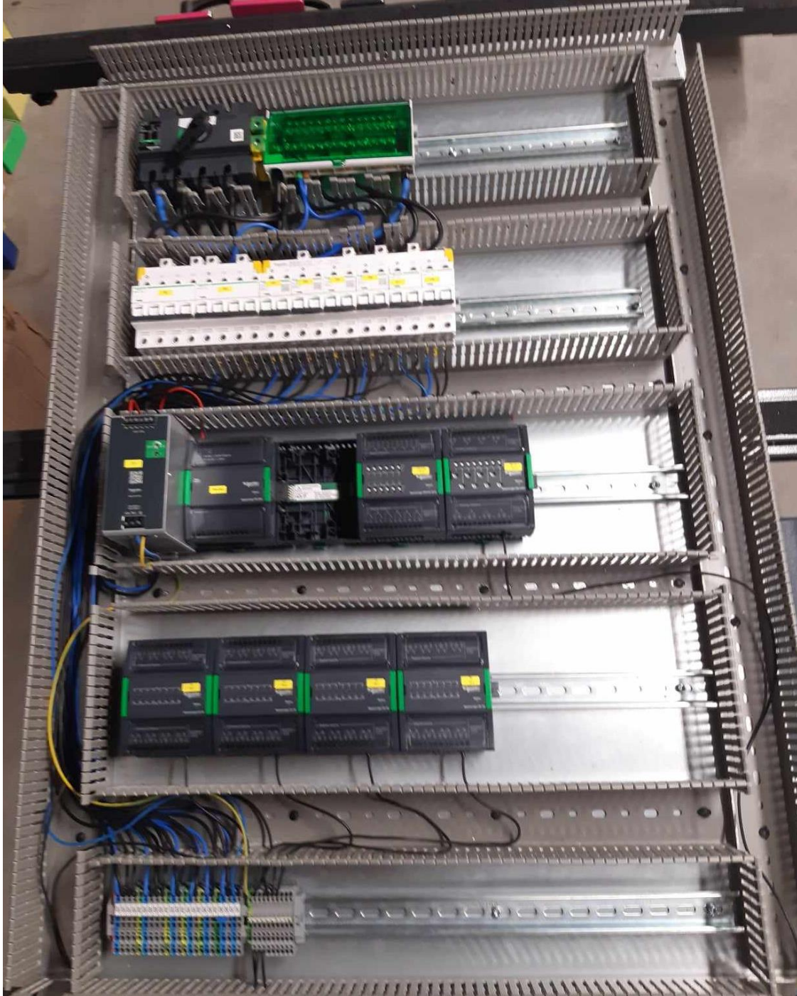
Figuur 45: Interne bekabeling HVAC-kast
