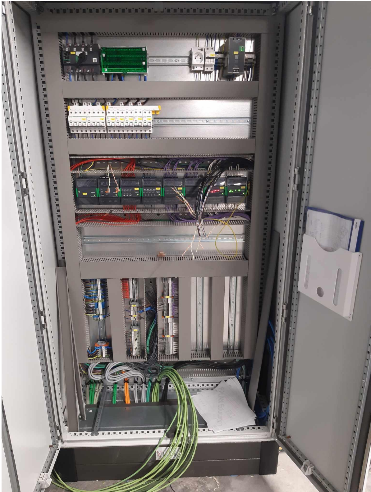
Figuur 46: Operationele HVAC-kast
